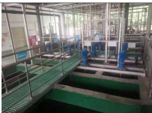
综合废水处理站照片1
