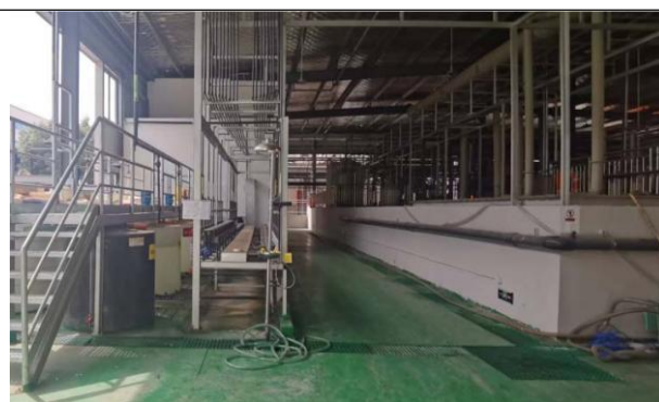
综合废水处理站照片2
