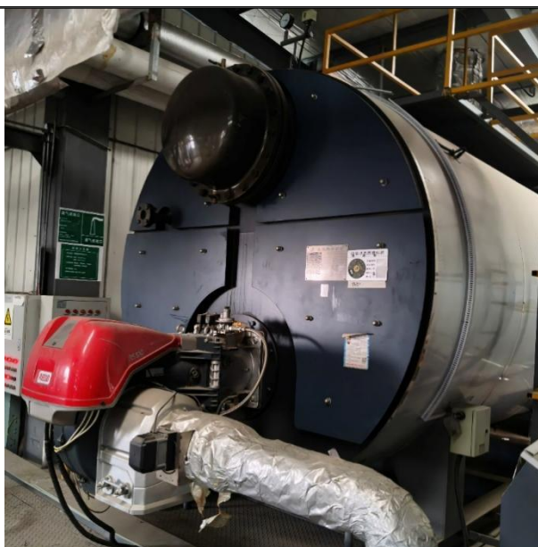
5#厂房锅炉废气（DA009）：低氮燃烧器装置
