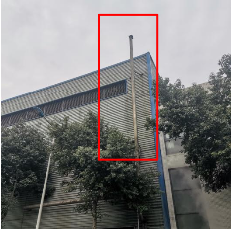
喷砂机废气处理系统排气筒现状照片
