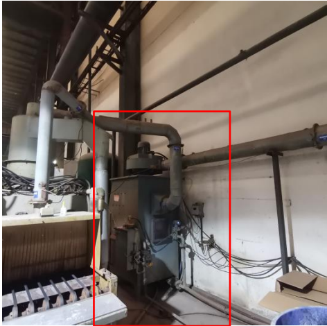
喷砂机布袋除尘器现状照片
